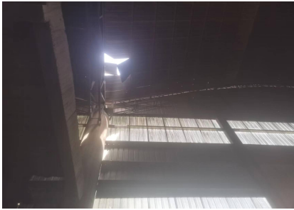
踩破的棚顶照片
